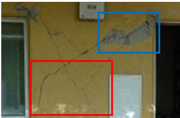
図 2 建物壁面の剥落(赤枠)、ひび割れ(青枠)の一例[2]
