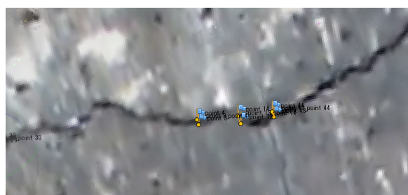
(a) 亀裂幅に設置されたマーカ・スケールバー
